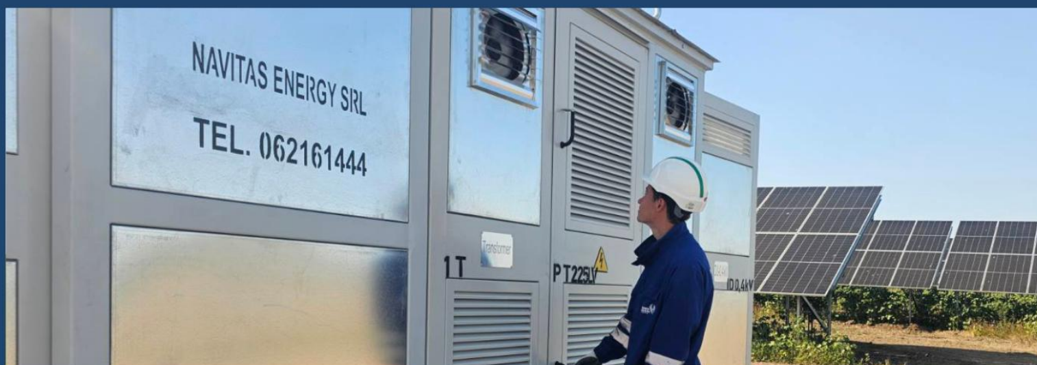
Parc fotovoltaic al Premier Energy în Republica Moldova.
