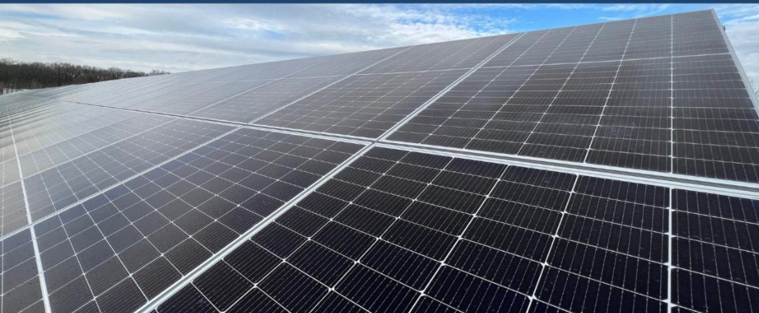
Parcul fotovoltaic de 1,9 MW al Premier Energy, situat în județul Prahova, România.
